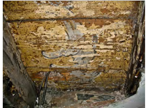
Il. 3 Stan zachowania polichromii na deskach stropu Wysokiej Sieni. Widoczne przemalowania, wyluszczenia i przebarwienia warstwy malarskiej, fot. S. Socha-Bystroń
