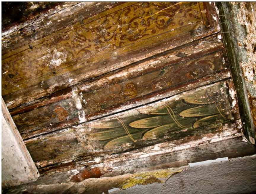
Il. 6 Pomieszczenie w trakcie tylnym parteru. Stan zachowania XVI-wiecznej polichromii na dylach stropu, fot. L. Czyżniewska
