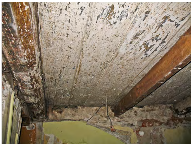
Il. 17 Pomieszczenie I piętra w tylnym trakcie. Widok stropu po odsłonięciu spod oszalowania, fot. A. Bystroń-Kwiatkowska
