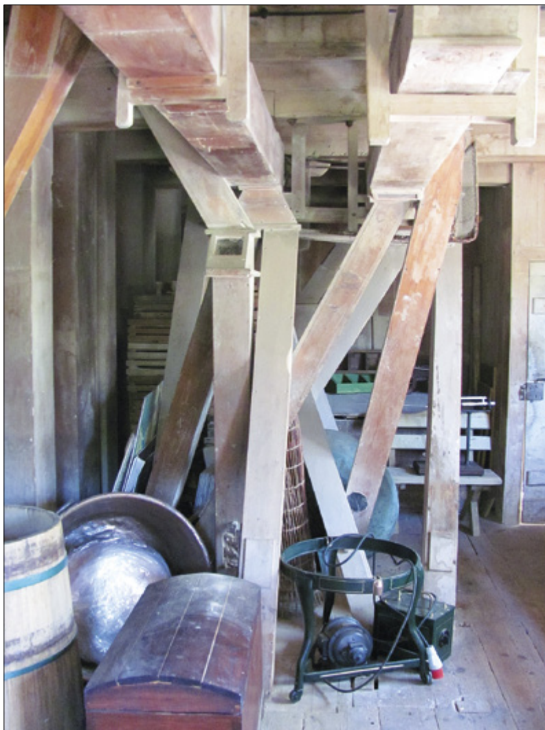
Il. 6. GRUCZNO, Młyn wodny, wewnątrz – pierwsze piętro, zagęszczenie rur spadowych w południowo-wschodniej części młyna. Fot. D. Jagiełło
