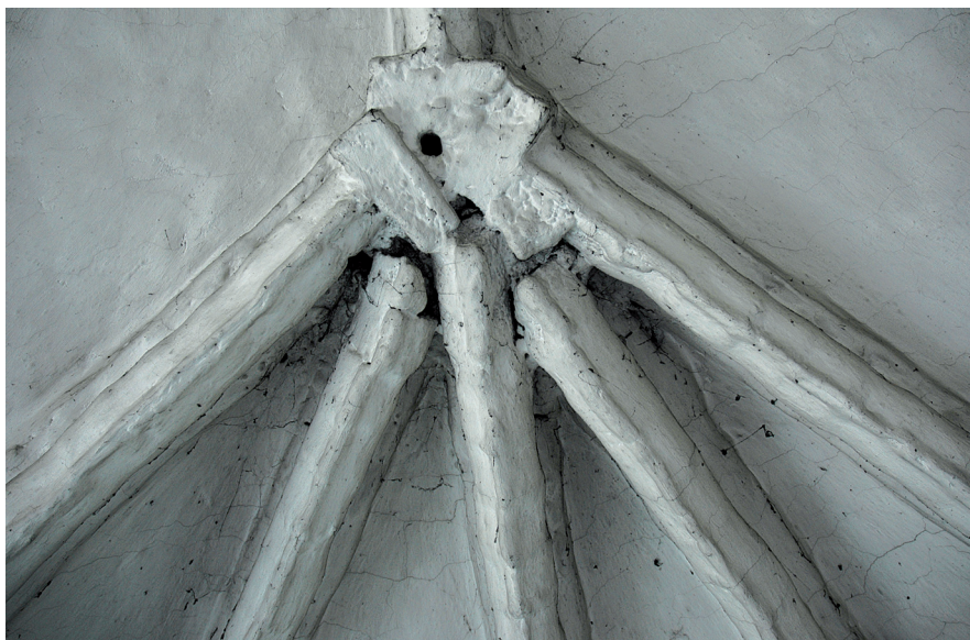
Il.2 Sklepienie nawy południowej, warsztat murarski z II poł. XV w. – niestaranne łączenie żeber sklepiennych, fot. I. Brzostowska
