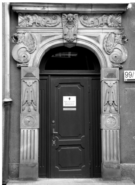
Il. 7 Gdańsk, kamienica przy ul. Ogarnej 99, portal, nieznaną warsztat gdański, ok. poł. XVII w., rekonstrukcja, fot. F. Skibiński
