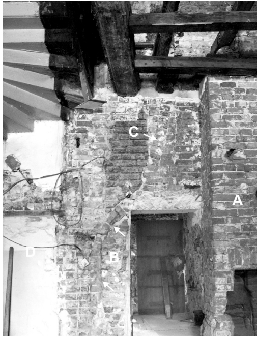
Il. 5 Parter, trakt frontowy. Widok na mur międzytraktowy. A – komin wzniesiony po likwidacji w tym miejscu pieca kuchennego; B – relikw goetyckiej wnęki; C – ślad po kapturze pieca kuchennego; D – zamurowane współcześnie dawne przejście, fot. E. Nawrocka
