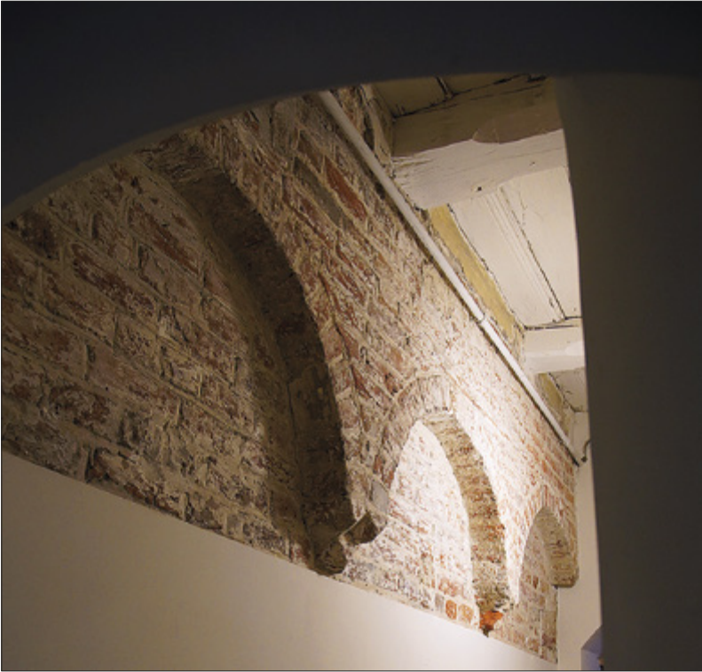
II. 2. Toruń, kamienica przy Rynku Staromiejskim 25, zachowany fragment arkadowej artykulacji muru na ścianie zachodniej w trakcie tylnym. Fot. J. Raczkowski
