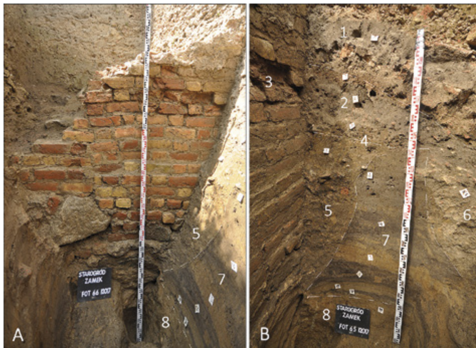
II. 15. STAROGRÓD, wykop 1: A – mur parchamu; B – fragment profilu północno-zachodniego; 1 – warstwy z okresu rozbiórki muru; 2 – warstwy powstałe w fosie w okresie nowożytnym; 3 – miejsce pęknięcia lica muru parchamu; 4 – poziom gruntu przy murze z początku XIV w.; 5 – wypełnisko rowu fundamentowego muru; 6 – pogłębienie fosy z początku XIV w.; 7 – warstwy akumulacyjne fosy powstałe w ciągu 2. poł. XIII w.; 8 – glina naturalna (calec) – dno fosy z lat 30. XIII w. Rys. B. Wasik
