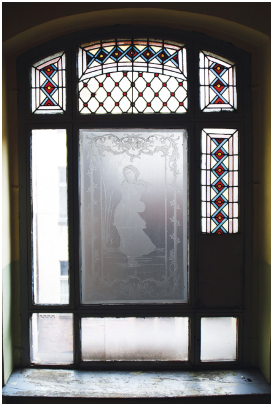
Il. 7. TORUŃ, ul. Piastowska 5, zachowany fragment witrażu mozaikowego okna klatki schodowej oraz „łyżwiarka” wykonana w technice trawionego szkła. Fot. A. Kaźmierczak
