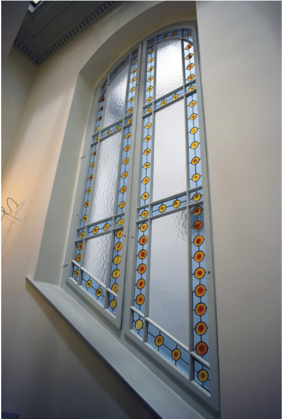
Il. 4. TORUŃ, ul. Kazimierza Jagiellończyka 6, okno klatki schodowej, szklenie ołowiowe (gomółki i szkło katedralne) oraz szkło ornamentowe. Fot. A. Kaźmierczak
